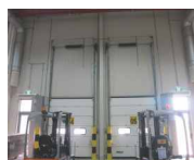
overhead section door
